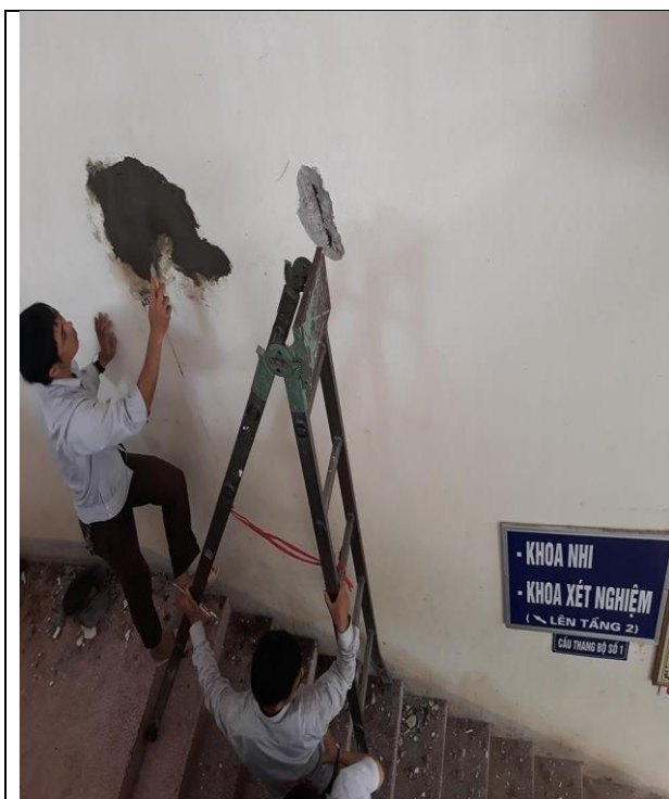
5. Ý kiến của BN đề nghị sơn, sửa lại bờ tường cầu thang lên khoa Nhi, đang khắc phục
